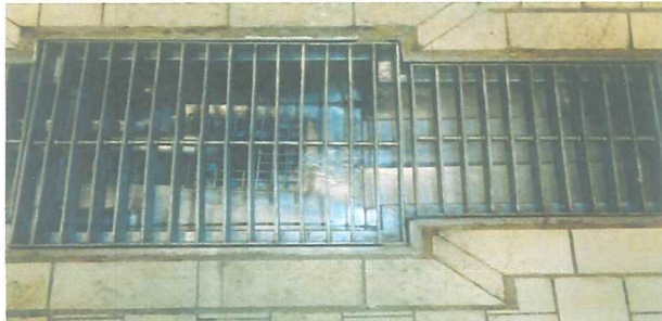
Hố thu gom nước thải khu vực bên trong nhà xưởng sản xuất
