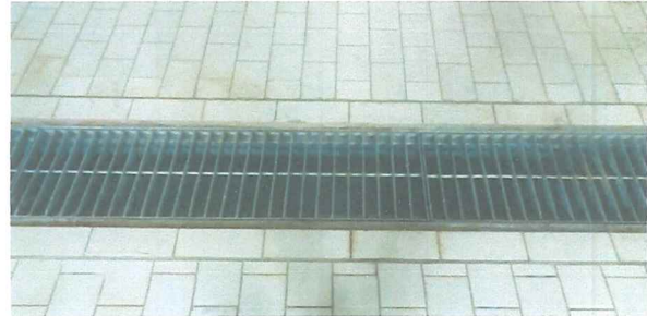
Hệ thống thu gom nước thải khu vực bên trong nhà xưởng sản xuất
